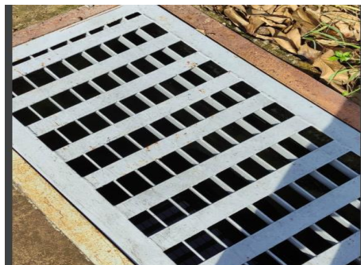
Hố ga đầu nối nước mưa với KCN
